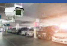
防犯カメラ設備
